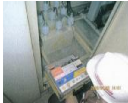
高壓變壓器、比壓器、比流器、 避雷器電容器檢測『合格』
