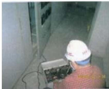
高壓保護電驛檢測『合格』
